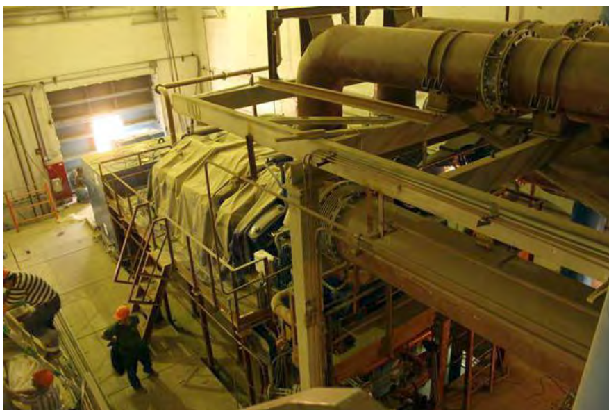
Рис. 5. Один из залов ячейки № 3 резервной дизельной электростанции
