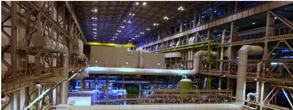
Рис.2. Машинный зал Юго-Западной ТЭЦ. Первая очередь
